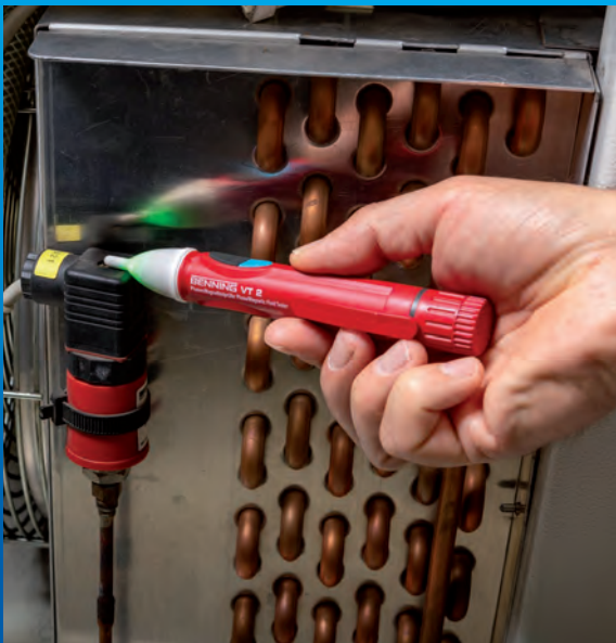
Prüfung eines Magnetventils mit BENNING VT 2
