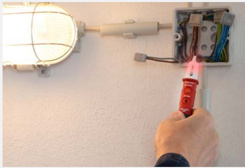
Prüfung auf Vorhandensein von Wechselspannungen für die schnelle Fehlersuche
