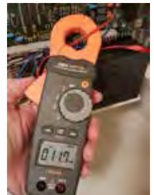
Messung an der Alarmanlage (Ladestrom / Betriebsstrom)
