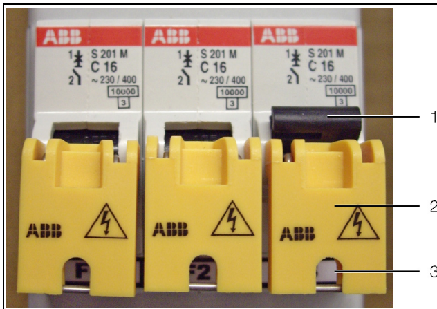
Abb. 10: Sicherung der Schaltsperre
