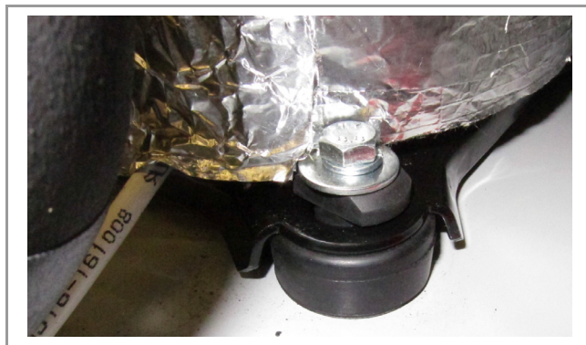
Rys. 3.3: Stopa antywibracyjna sprężarki
